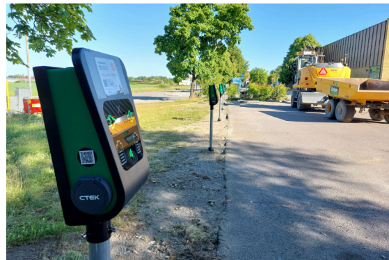
Laddstolparna installerades av Mälarenergi i juni på parkeringen längs Kvistbergavägen intill busshållplatsen. Foto: Hannes Lyckholm
